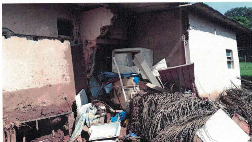
Figura 4 – Lateral Esquerda da edificação destruída pela lama
