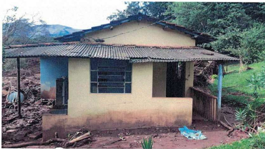
Figura 2 – Fachada frontal da edificação tomada pela lama
