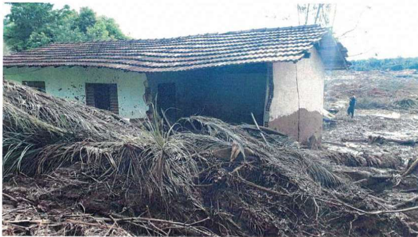
Figura 5 – Lateral direita da edificação completamente destruída pela lama
