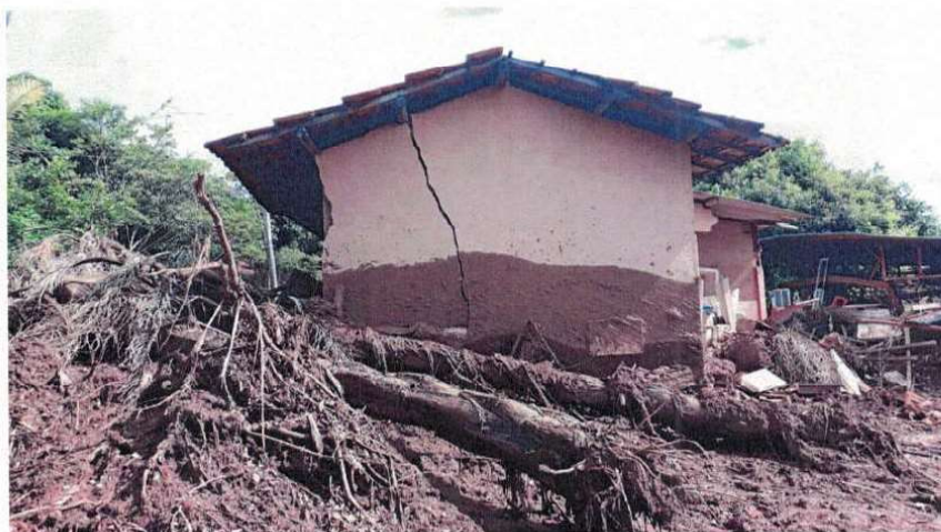
Figura 3 – Fachada dos fundos da edificação destruída pela lama
