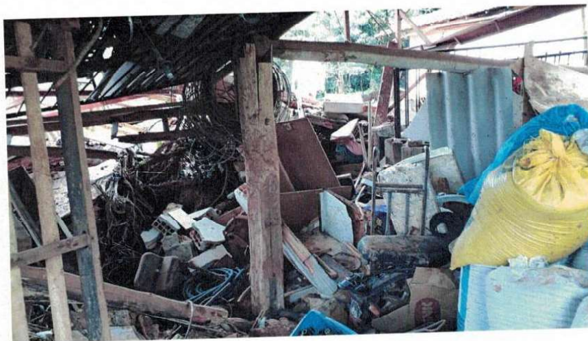
Figura 1 – Escombros da edificação
