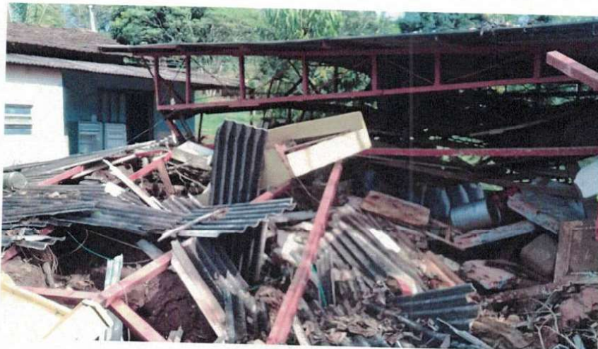
Figura 2 – Escombros da edificação
