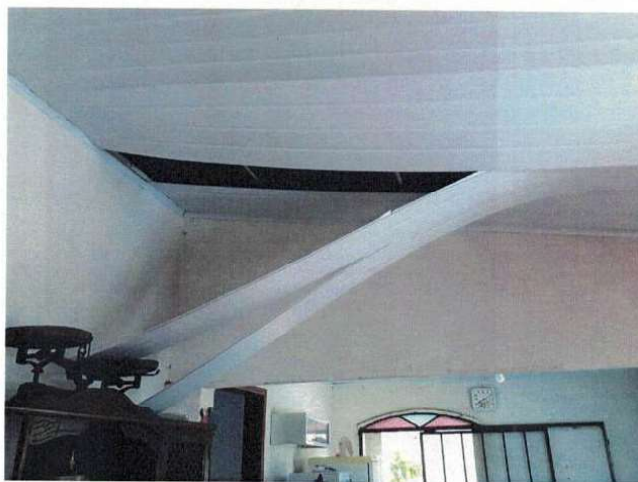
Figura 8 – Desprendimento do forro
