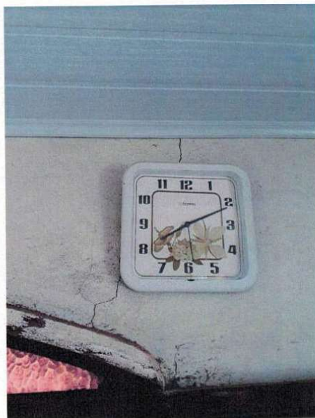
Figura 5 – Trinca na parede da cozinha
