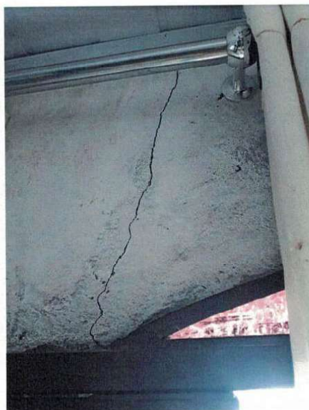
Figura 6 – Trinca na parede interna da sala
