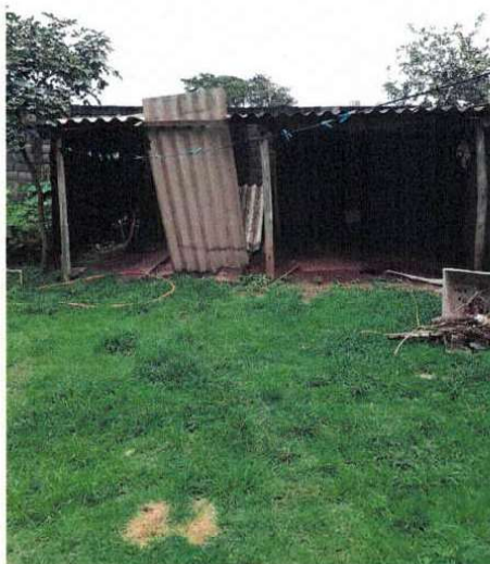
Figura 9 – Destelhamento parcial da garagem
