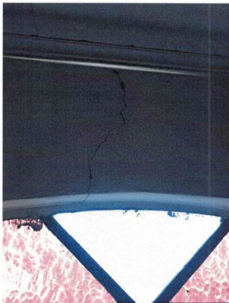
Figura 4 – Trinca na parede do quarto
