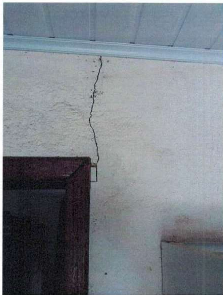
Figura 3 – Trinca existente na cozinha que houve uma maior dilatação
